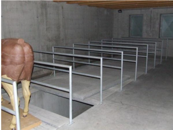
Die vermisste Person stürzte in die Öffnung der Jauchegrube.
